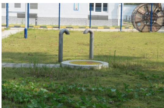
升压站事故油池
