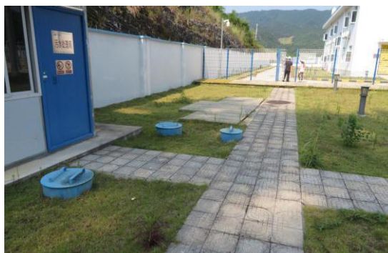
升压站污水处理设施
