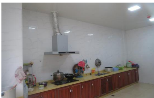
升压站食堂抽油烟机
