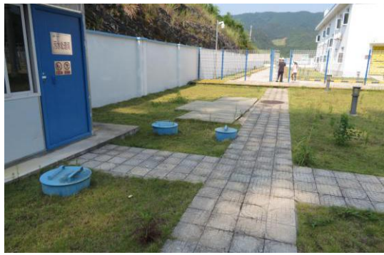
地埋式污水处理设施
