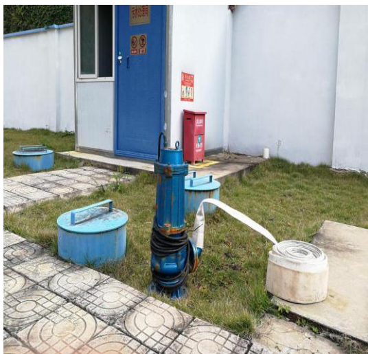
污水设施配备的抽水泵
