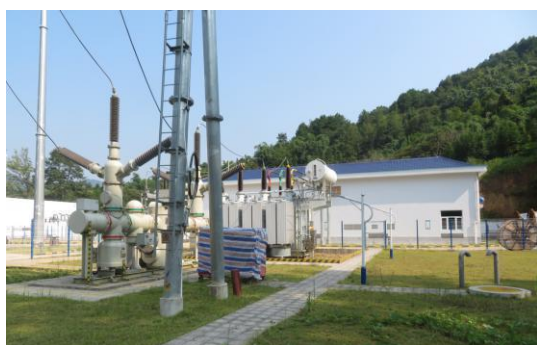
升压站主变压器
