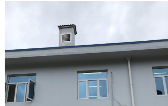
升压站厨房烟窗
