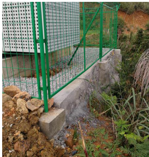
F22 风机箱变已设拦水坎坝
