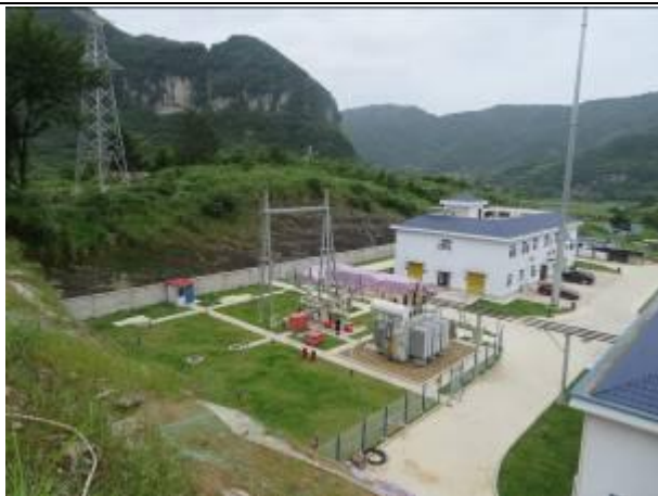
升压站站区绿化
