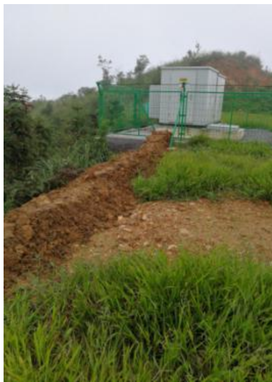
22#风机箱变已设拦水坎坝高于平台
