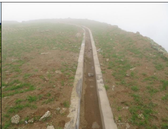
5#风机平台混凝土截排水沟
