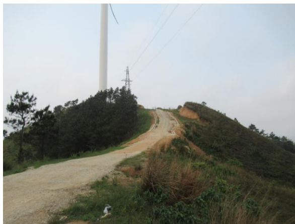
1#风机道路截排水设施
