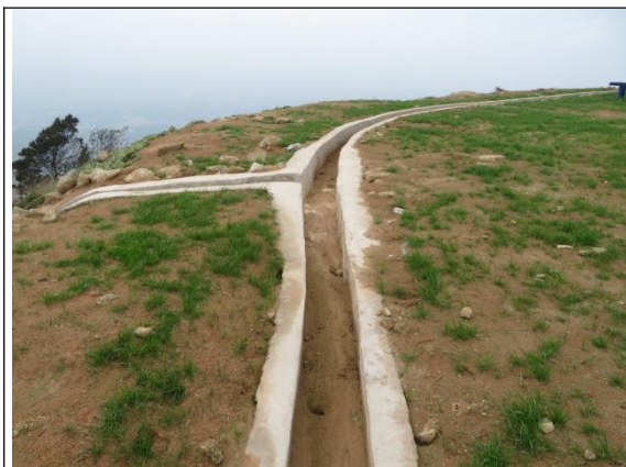
2#风机平台混凝土截排水沟
