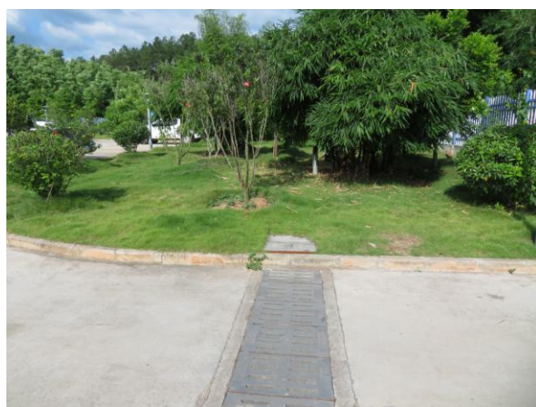
站内截排水设施
