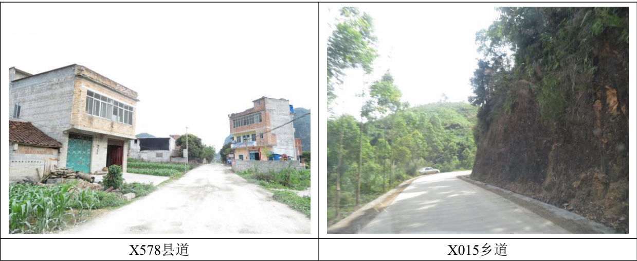
图2.1-1 现有道路局部路面现状
