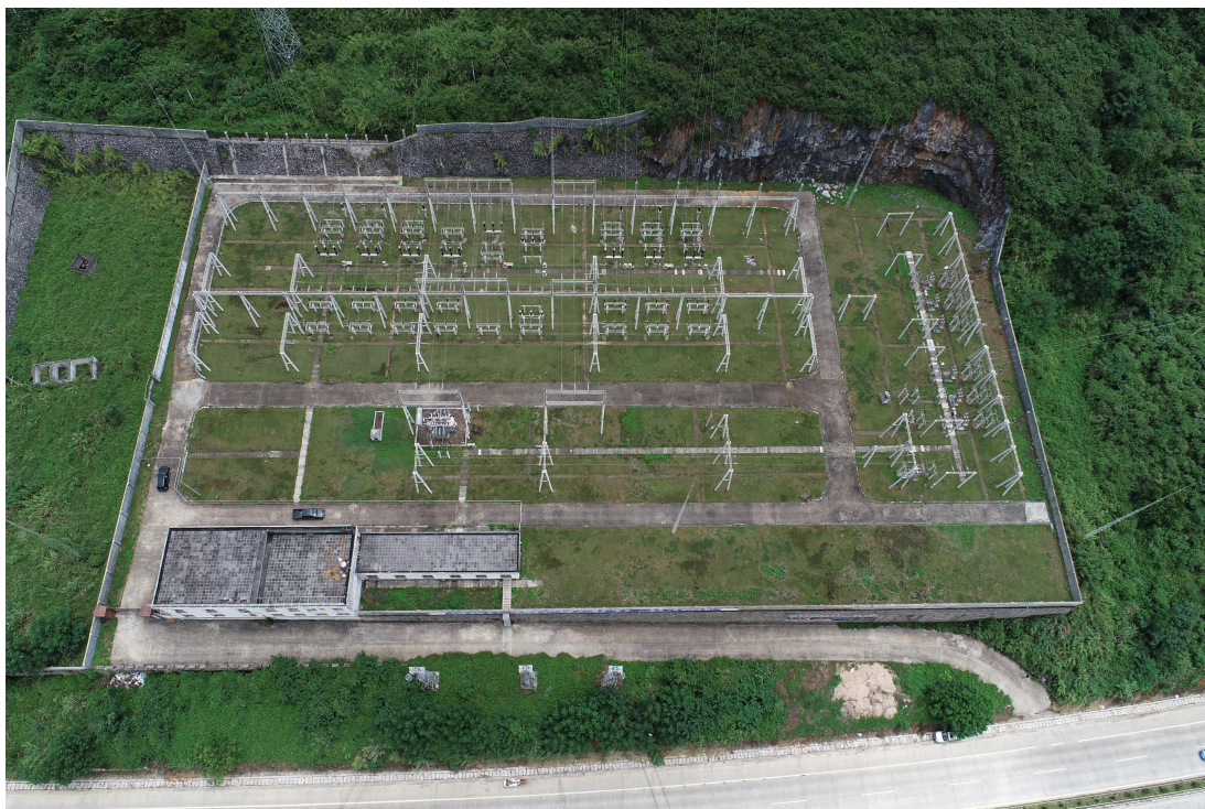
附图 1 110kV 白沙变电站
